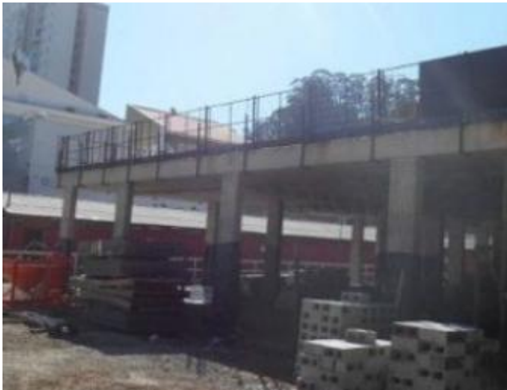
Imagem 3: Proteção Periférica Sargento
